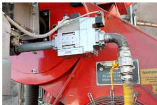
800 KW GASSFYRING: Opland valgte gass framfor diesel til fyring, da gass har litt høyere energiinnhold per kilo og høyere virkningsgrad, på grunn av at den er direktefyrt. Til gjengjeld er gass noe dyrere enn diesel og kan ikke tas med om mobiltørka må flyttes.
